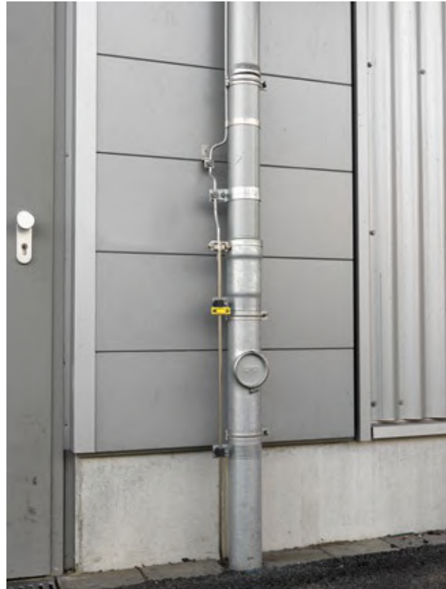
Blitzschutzableitung an einem Regenfallrohr
